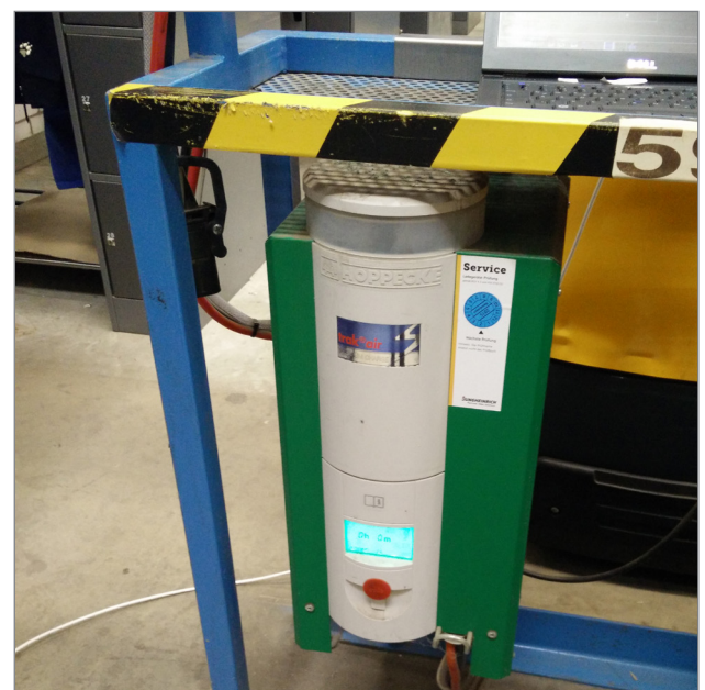
Eine von insgesamt 20 zu überwachenden Ladestationen für die E-Gabelstapler im Hochregallager von Ritzenhoff & Breker in Bad Driburg.
