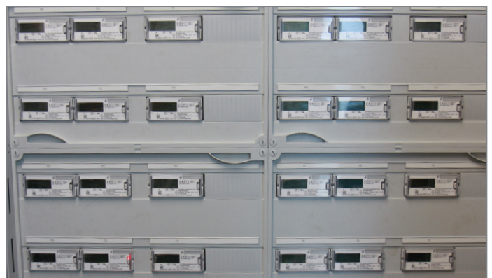
Drehstromzähler DHZ+ im Einsatz im Stiftungsdorf Walle, auf den Grundmauern des Waller Wasserturms errichtet und seit Januar 2018 bezugsfertig.
